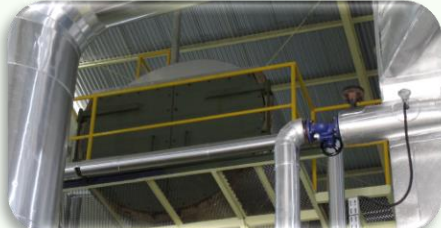
Biomassa untuk boiler
